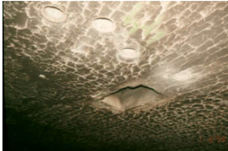
Abb. 3: Nahaufnahme Zwischendecke "gering geschädigt"
