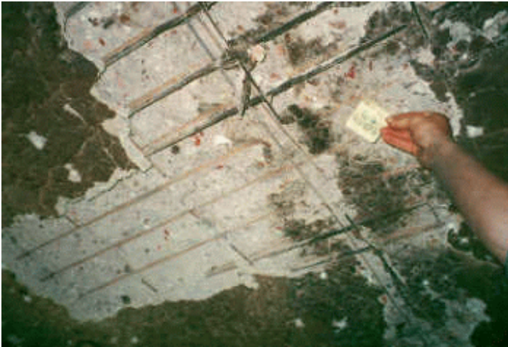
Abb. 1: Zwischendecke "stark geschädigt"
