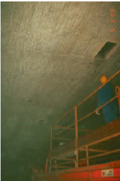
Abb. 2: Zwischendecke "gering geschädigt"
