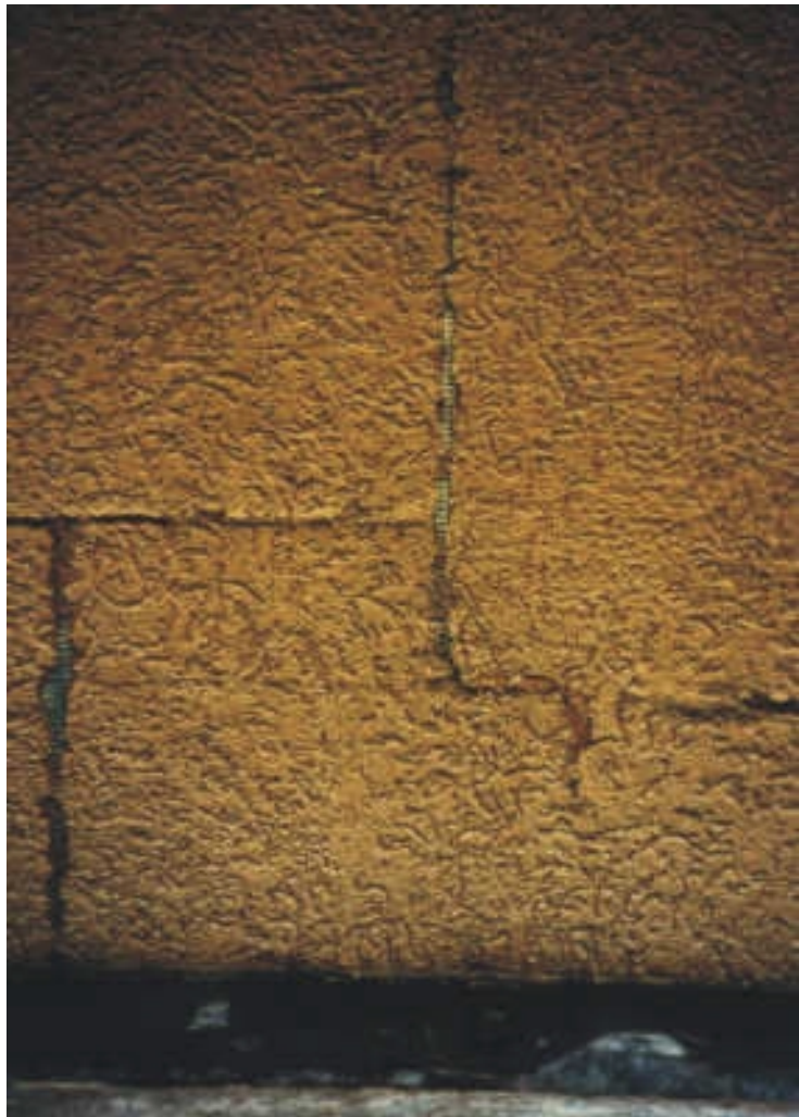
Bild 4: Systematische Risse entlang der Fugen zwischen Wärmedämmplatten
