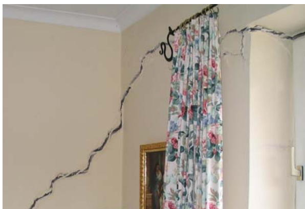
Bild 1: Setzungsschaden; die Nutzung und der Wert des Objektes sind stark eingeschränkt
