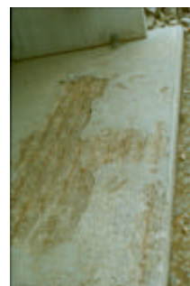
Frost-Tausalz-Schaden an der Bodenplatte eines Buswartehäuschens
