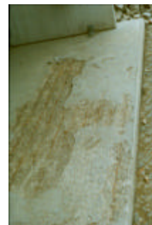
Frost-Tausalz-Schaden an der Bodenplatte eines Buswartehäuschens
