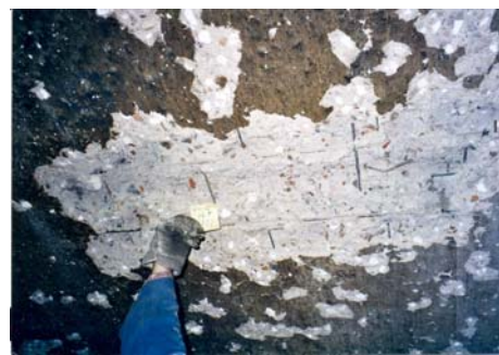
Bild 2: Betonabplatzungen durch einen Brandschaden
