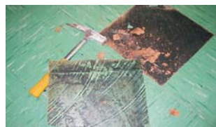
Floor-Flex-Fliesen mit Bitumenkleber (PAK, Asbest)
