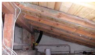
Dachstuhl- und Schalungsholz (Holzschutzmittel, PAK, DDT)
