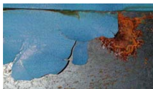
Anstriche (Schwermetalle, PCB)
