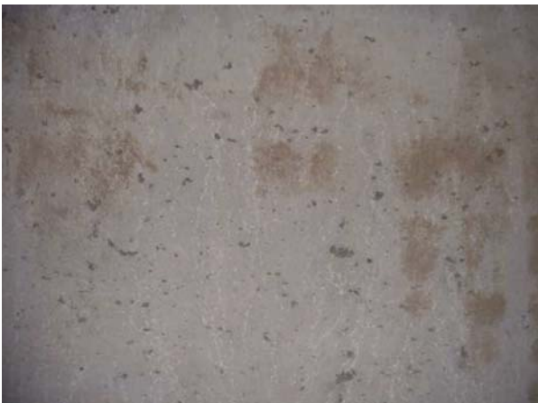
Bild 3: Farbveränderungen an Sichtbetonfläche durch zu hohen Trennmittelauftrag auf der Schalungsfläche (Pfützenbildung) und ausgeprägte Lunkerbildung
