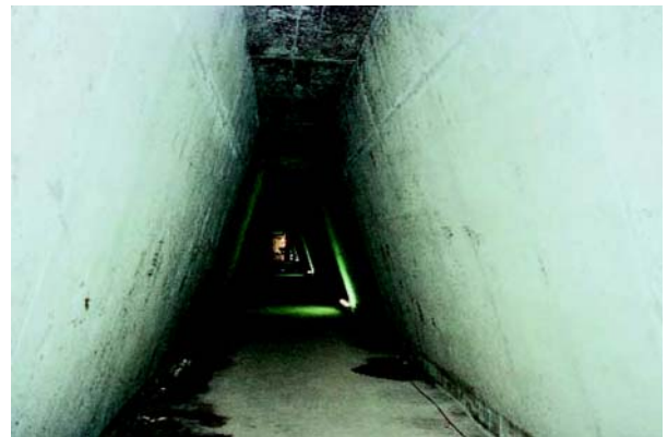
Bild 4: Pilzbefall in einem Kanalbauwerk
