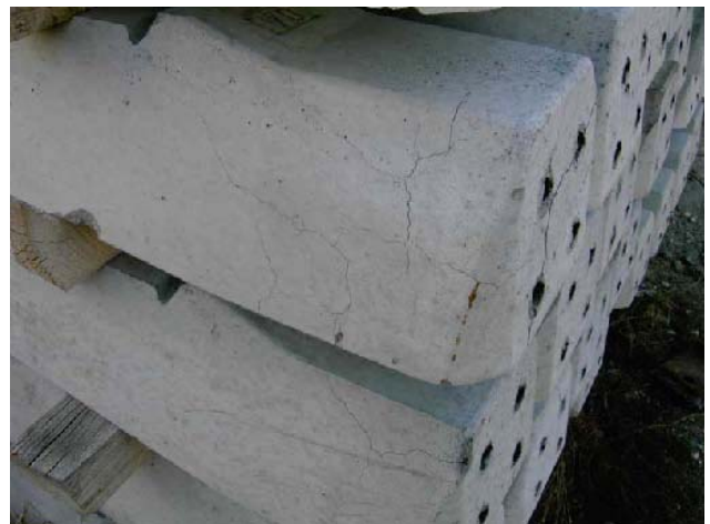
Bild 2: AKR-Schaden an Gleisbahnschwellen in Form von Netzzissen (Bsp. aus Rumänien)
