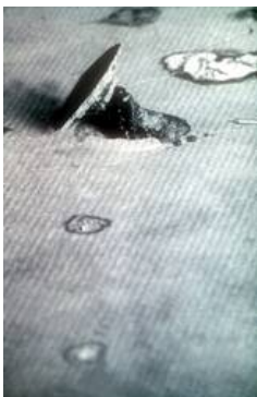
Bild 1: AKR- Schaden an einer Betonoberfläche (Bsp. aus Norddeutschland)
