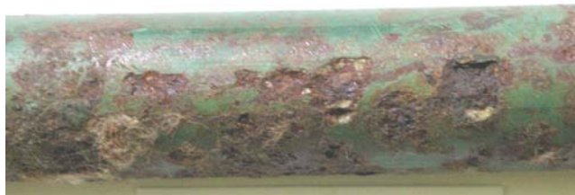
Bild 4 Detail mit Grübchen- und Muldenkorrosion (Aufnahme ÖGI/Leoben)
