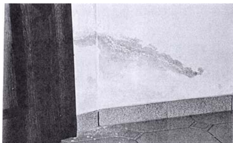
Bild 1: aufsteigende Feuchte an verputzten Wänden
