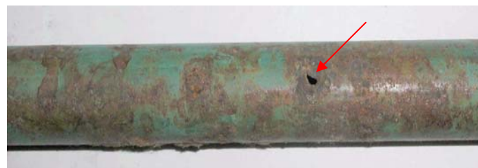
Bild 3: Heizungsrohrstück mit Lochfraßkorrosion (Aufnahme ÖGI/Leoben)
